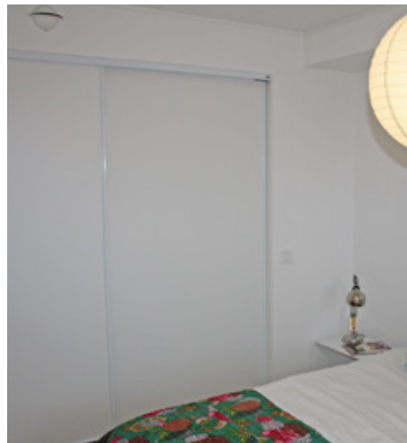
Alltid ljudklass B eller bättre (lägre än 26 dBA i sovrum). Tilluftsdon skymtar ovan skjutdörr.
